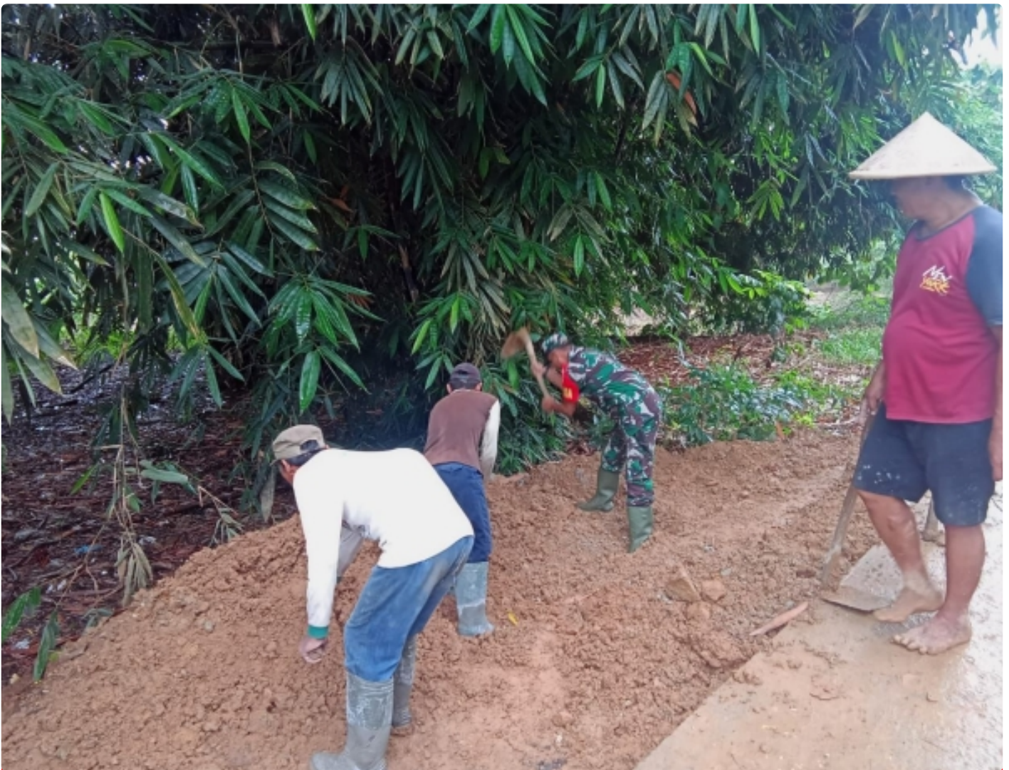
Serda Badri bersama warga masyarakat dan Pemerintah desa Wonoyoso melaksanakan pengurukan bahu jalan desa di Dusun Kedungpandan Desa Wonoyoso
