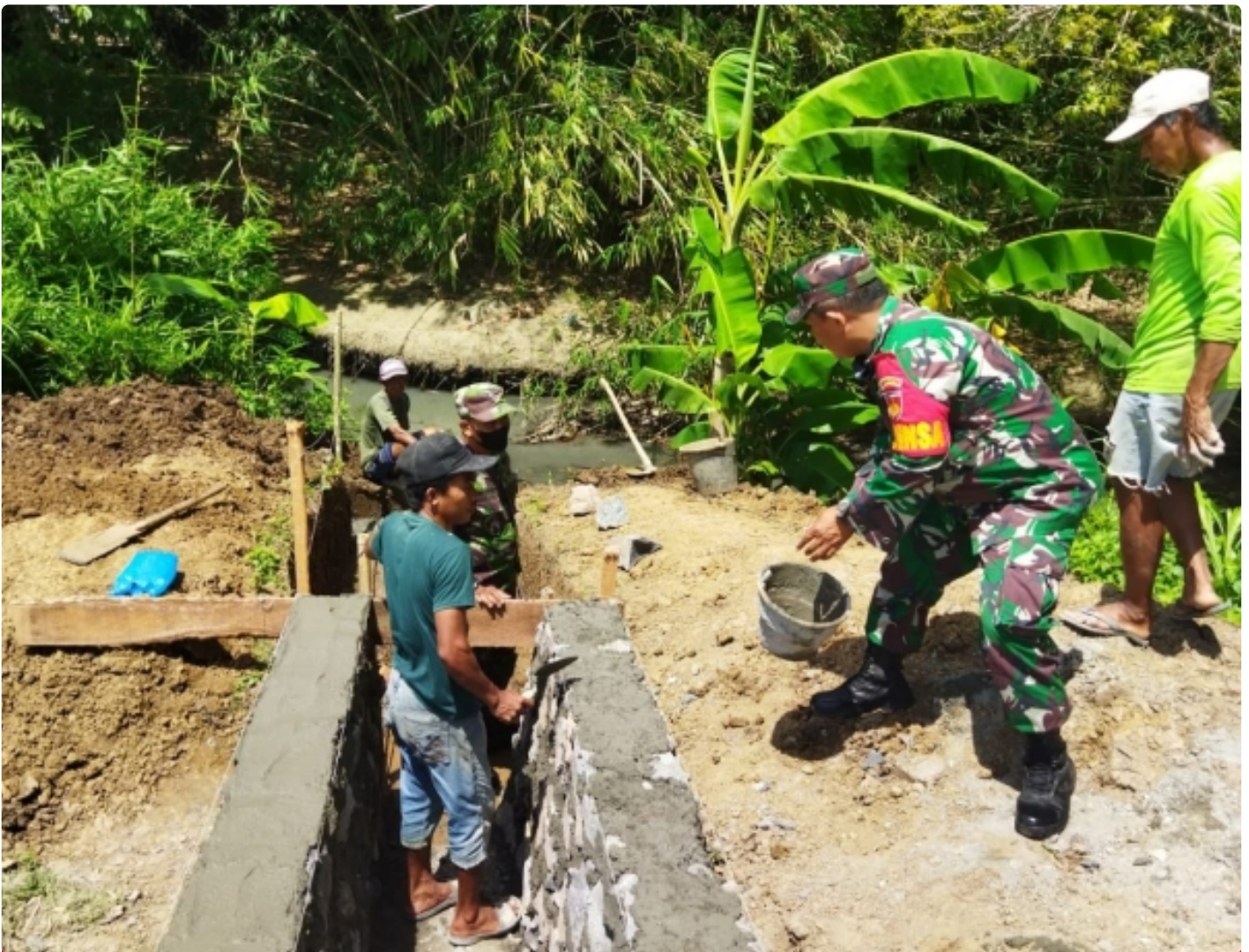
Babinsa Koramil 15/Klirong Bantu Warga Dalam Perbaikan Drainase Dan Gorong-Gorong Parit Jalan
